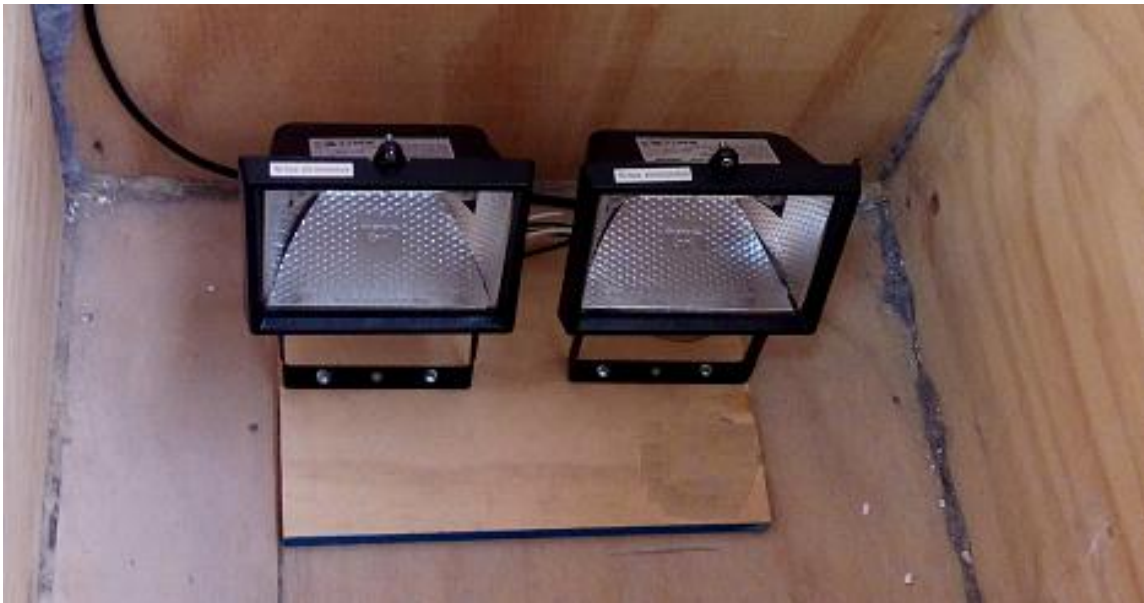
Figura 5.3: Fuente generadora de calor. Fuente: Elaboración propia
