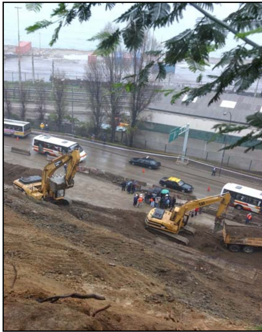
Fotografía N°2: Deslizamientos de Bloques Rocosos en Avda España.
