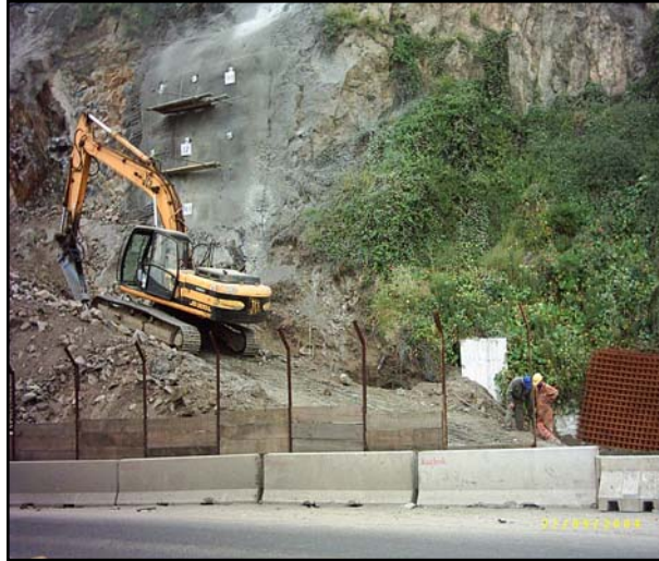
Fotografía N°3: Intervención Física, en el pie de talud del cerro. (Salida del Túnel de Acceso, al Puerto de Valparaíso).
