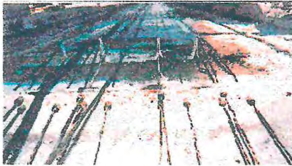
FOTO 4: CABEZAL DESDE DONDE SE REALIZA EL TESADO.
