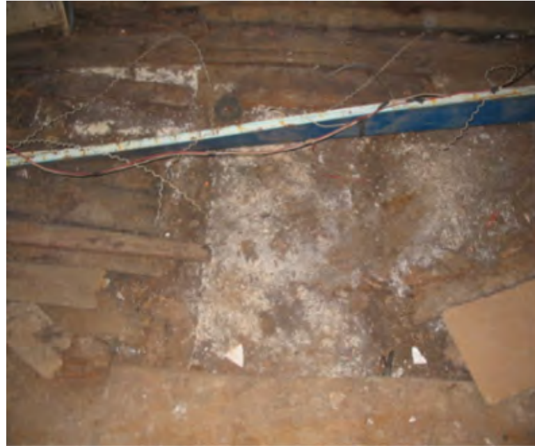
FIGURA N° 43 Piso de la bodega de la farmacia, donde producto de la humedad del suelo, la madera de piso de Alamo de 1/2"x4" se pudrió dejando a la vista el suelo natural sobre el cual se asienta el edificio.
