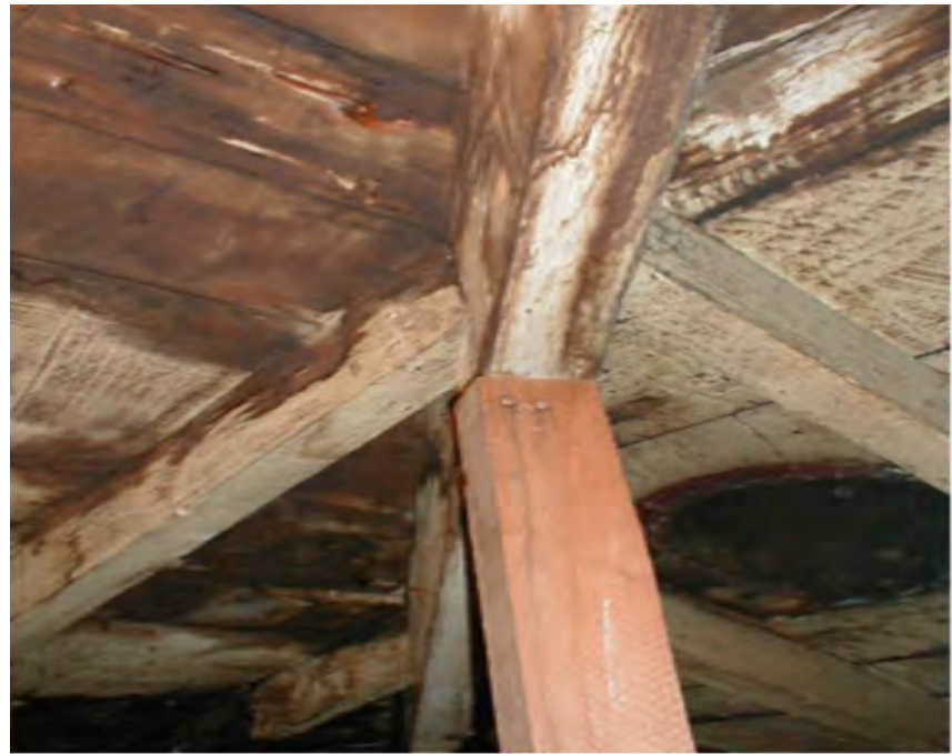
FIGURA Nº 45 Filtración de agua en la estructura de la cubierta, que dejan a la vista la posible pudrición de los elementos de madera. Si no se considera la mantención y sello de la cubierta para evitar posibles daños a la estructura de ésta y filtración de agua a los niveles inferiores
