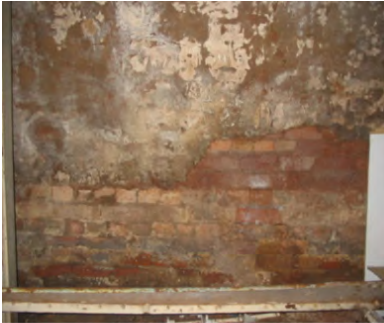
FIGURA N° 42 Muro de mampostería de ladrillo de la bodega de la librería que da a la fachada de Plaza Aníbal Pinto, que producto de la humedad ha producido un descascamiento del estuco.
