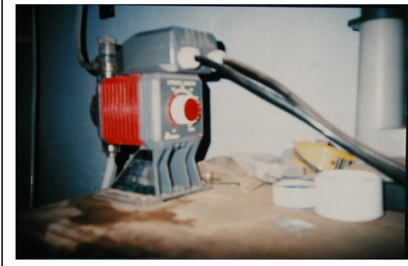
Fotos 8 y 9: Planta de agua potable del Comité de Aguas de Artificio.
