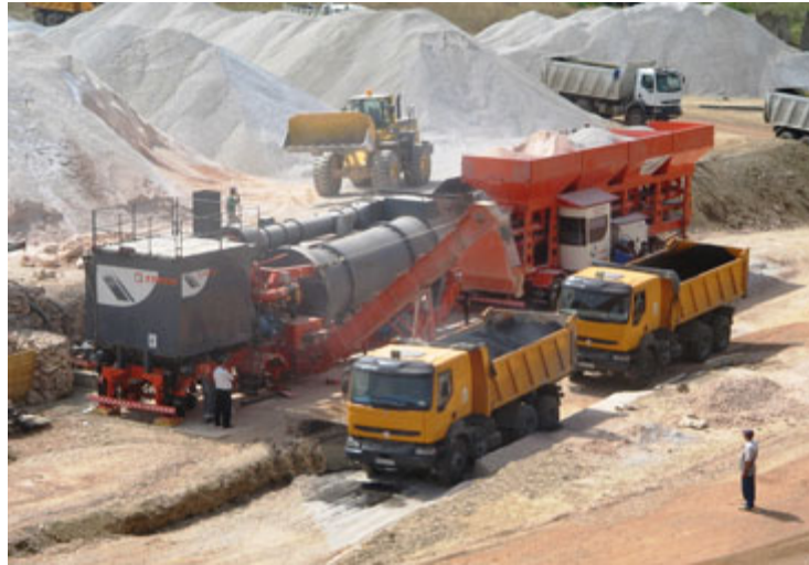
Figura 2-8: Planta Asfáltica, proceso de fabricación de una mezcla asfáltica en caliente.
