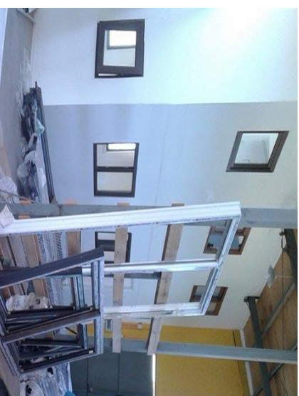
Figura 1.5: Pasillo inhabilitado por el acopio de refuerzos
