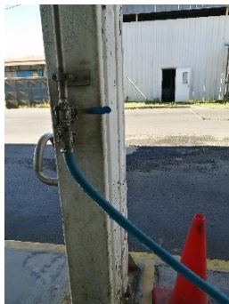
Figura 17 Manguera de limpieza externa de camiones cisterna.
