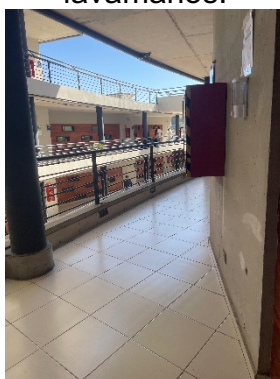
Elementos sobresalen más de 20cm.
