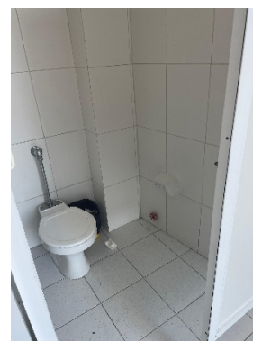
El área de aseo y baño no cuenta con pisos antideslizantes.
