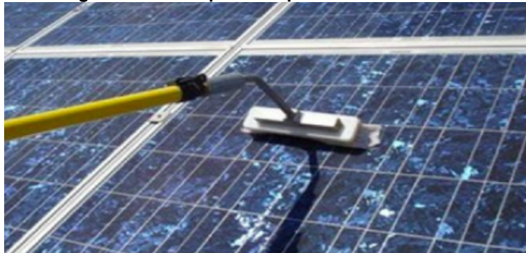
Figura 9.5 - Limpieza de paneles fotovoltaicos
