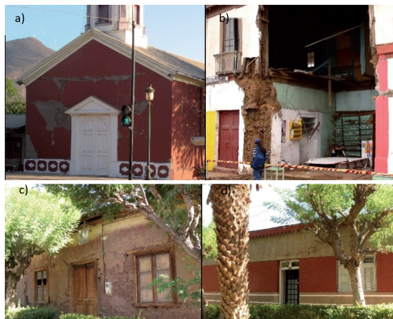
Figura 1.2: Fotografías de estructuras dañadas en localidades de la Región de Coquimbo tomadas en enero de 2016. a) Iglesia de Monte Patria, b) derrumbe de vivienda en Illapel, c) y d) viviendas contiguas en Combarbalá de adobe, con y sin daños, respectivamente, Fernández, Pastén, Ruiz, & Leyton (2017)
