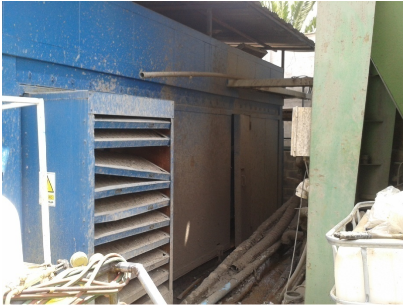
Figura 24: Sector donde se encuentra el Contenedor con el Generador Eléctrico
