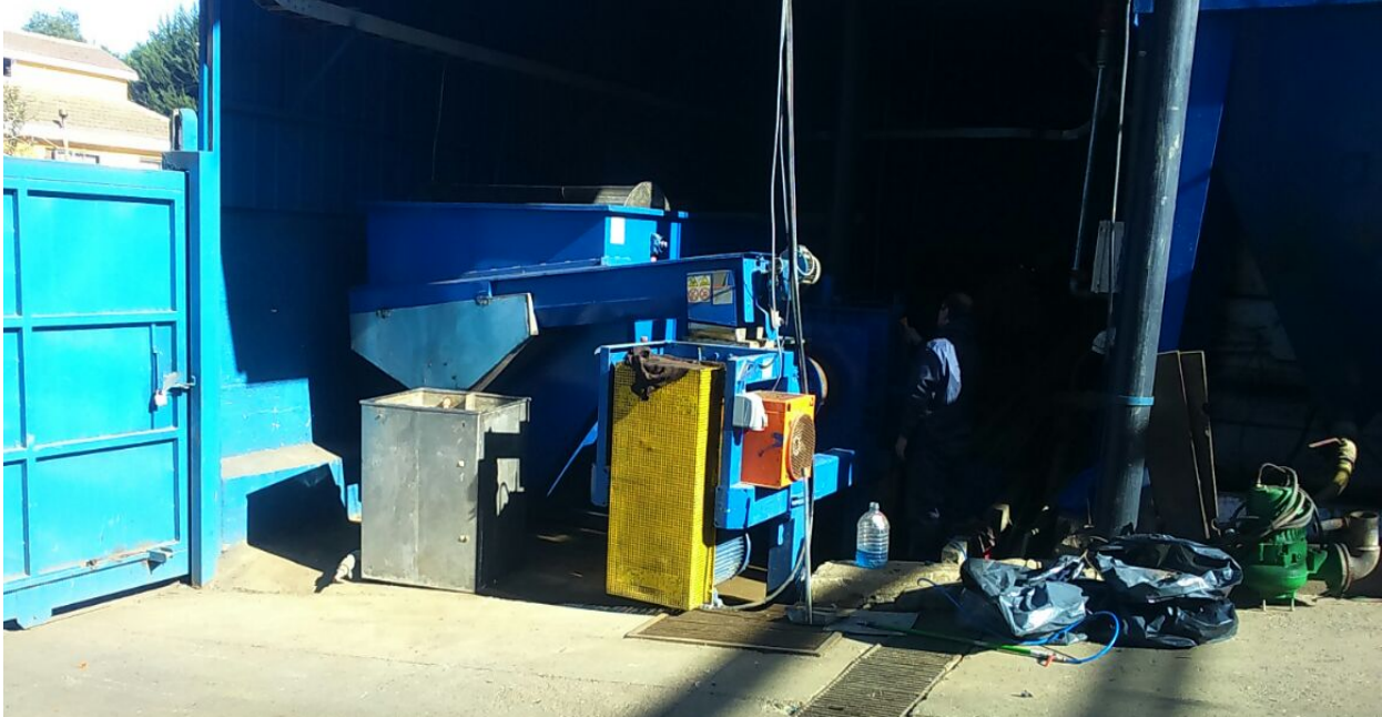
Figura 30: Celda de Flotación Instalada
