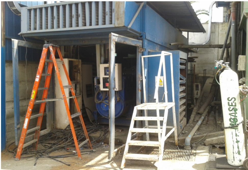
Figura 25: Sector donde se Encuentra el Contenedor con el Generador Eléctrico
