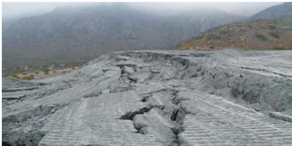
Figura 2.16. Deformaciones causadas en un muro de contención de relaves el 27-F en la región del Maule. Fuente: [30].
