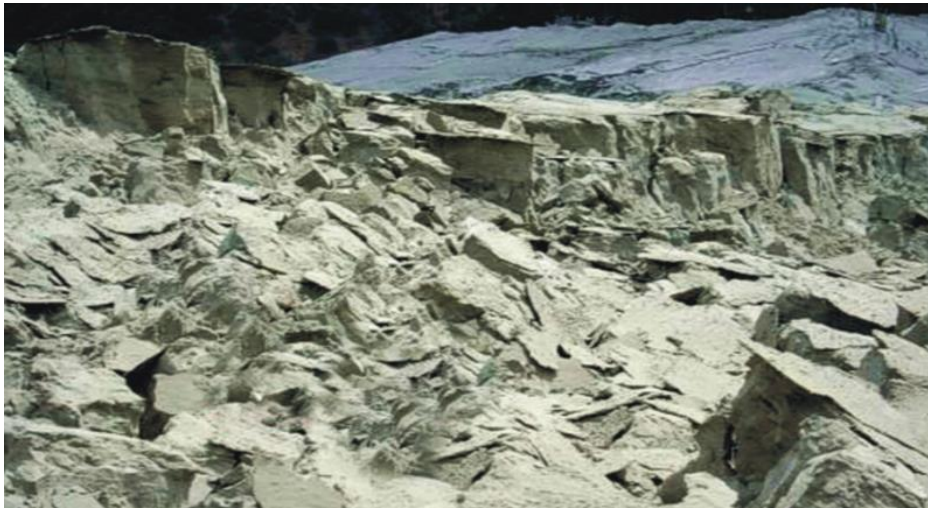
Figura 2.17. Deformaciones en la pendiente aguas arriba de un tranque de relaves, causadas por el asentamiento de limos subyacentes. Fuente: [30].
