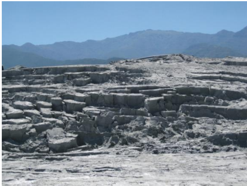
Figura 2.12. Terrazas formadas en un muro del tranque de relaves Las Palmas después del terremoto del 27 de febrero de 2010, Chile. Fuente: [30].
