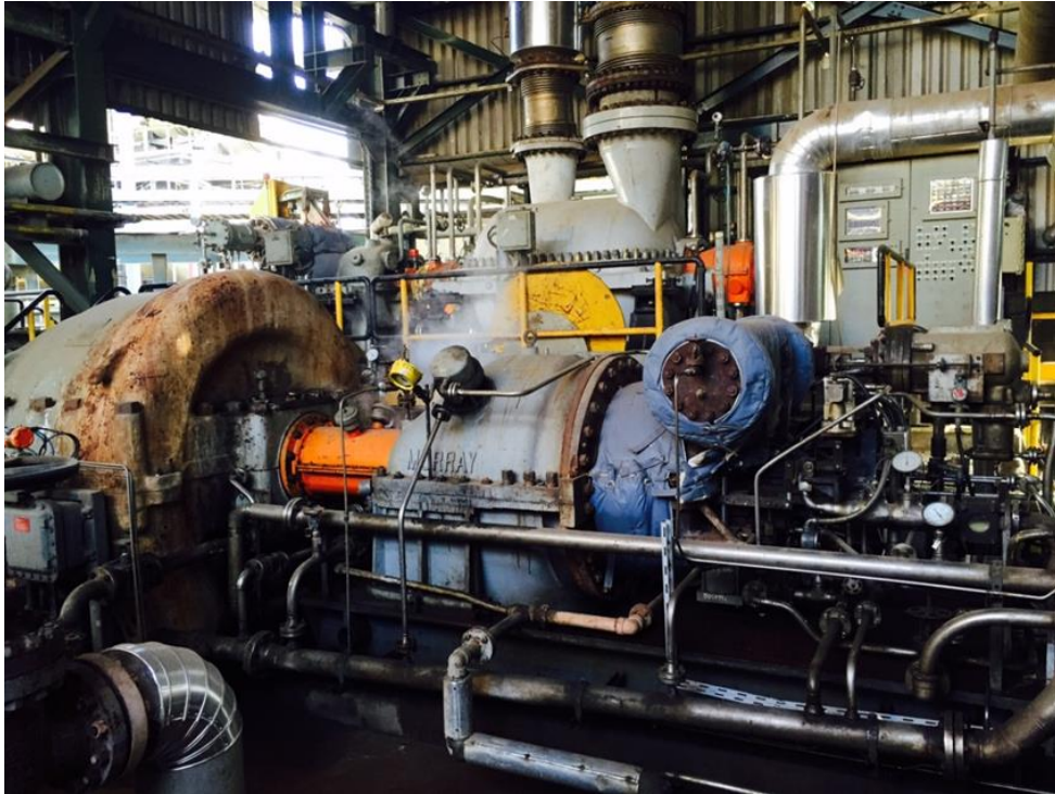
Figura 28.-: Compresor planta de Cracking Catalítico (fuente: sala de compresores ENAP)
