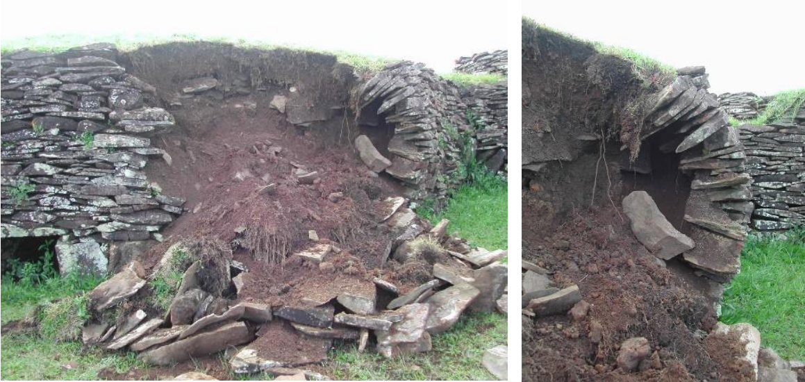
Fig. 99 Casa 15 a. Colapso del muro exterior, y deslizamiento del relleno de tierra detrás del muro.
