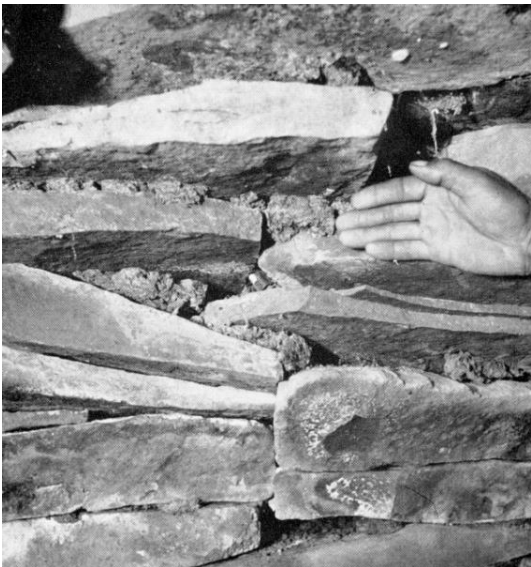
Fig. 48 Detalle de una sección de muro interior: A pesar de la impermeabilización del techo con pasto, entraba alguna humedad, puesto que en la casa R-34 (casa 35) se utilizó un relleno de totora seca (Ferdon 1961: 233, Plate 29b).
