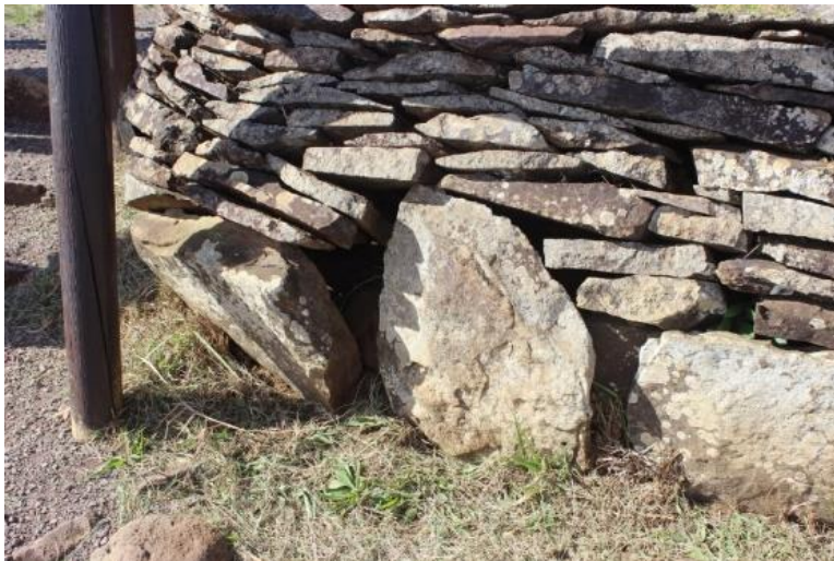
Fig. 98 Desplazamiento de lajas basales, colapso inminente del muro exterior.
