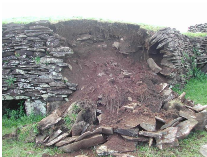
Fig. 69 Colapso del muro frontal de la casa 15 a (Foto del autor, Julio 2007)
