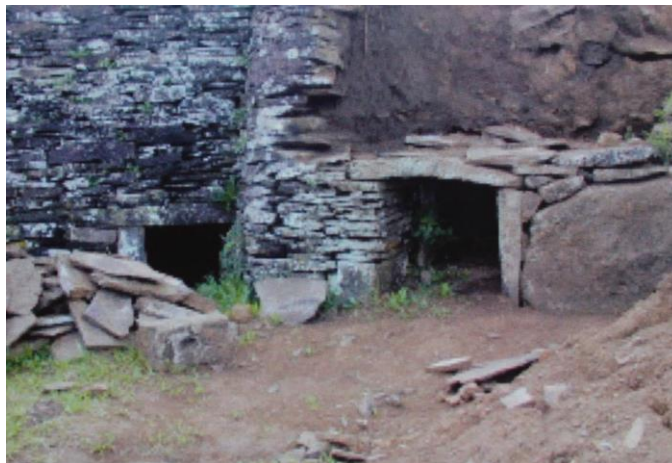
Fig. 68 Desplome del muro frontal de la casa 19, en el año 2004 (Pallarés 2009: 399).
