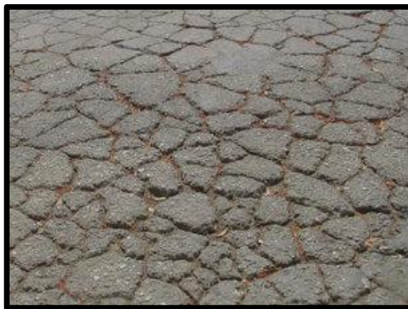
Figura 63- Falla tipo Piel de Cocodrilo. Fuente [14].
