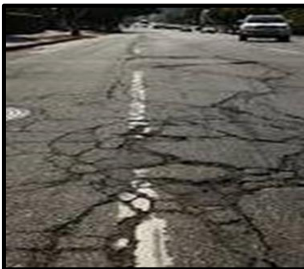
Figura 1.1 - Fisuración en Pavimentos Flexibles. Fuente [6].
