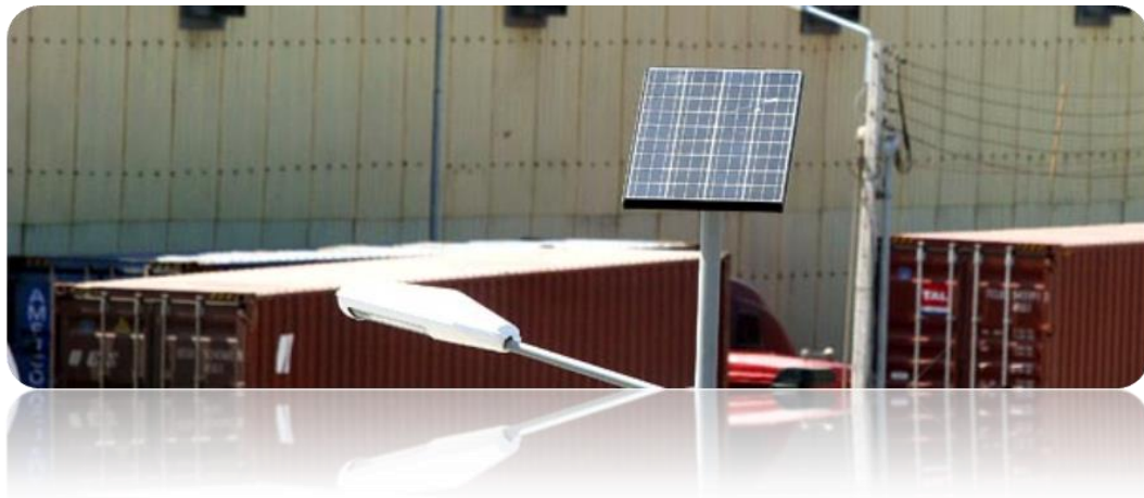
Ilustración N°28: Suministro de Instalación de Iluminarias en base a “Energías Renovables”
