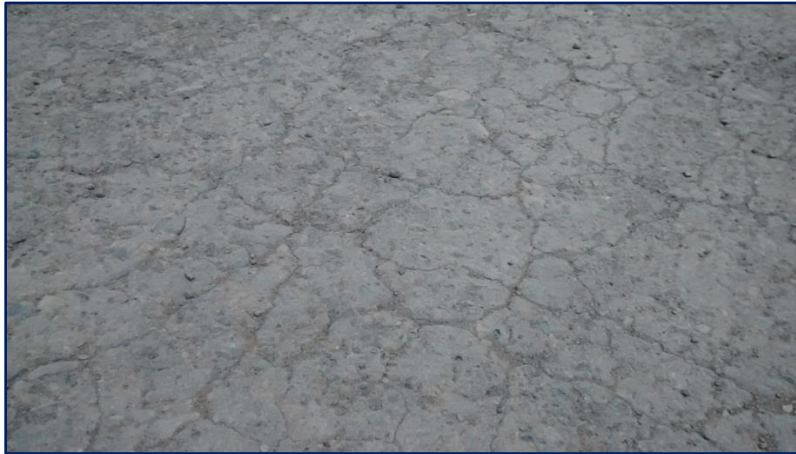
Figura 2.11: Grietas Tipo Piel de Cocodrilo
