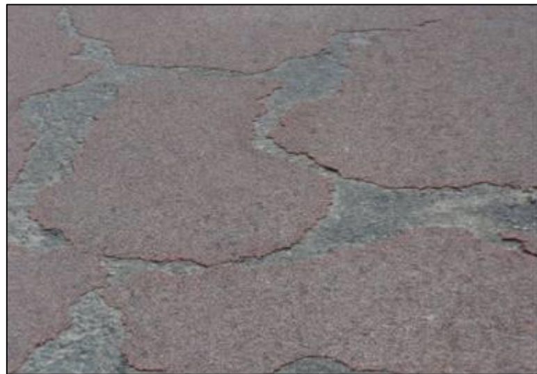
Figura 2.5-8 - Desprendimiento sello de alta fricción
