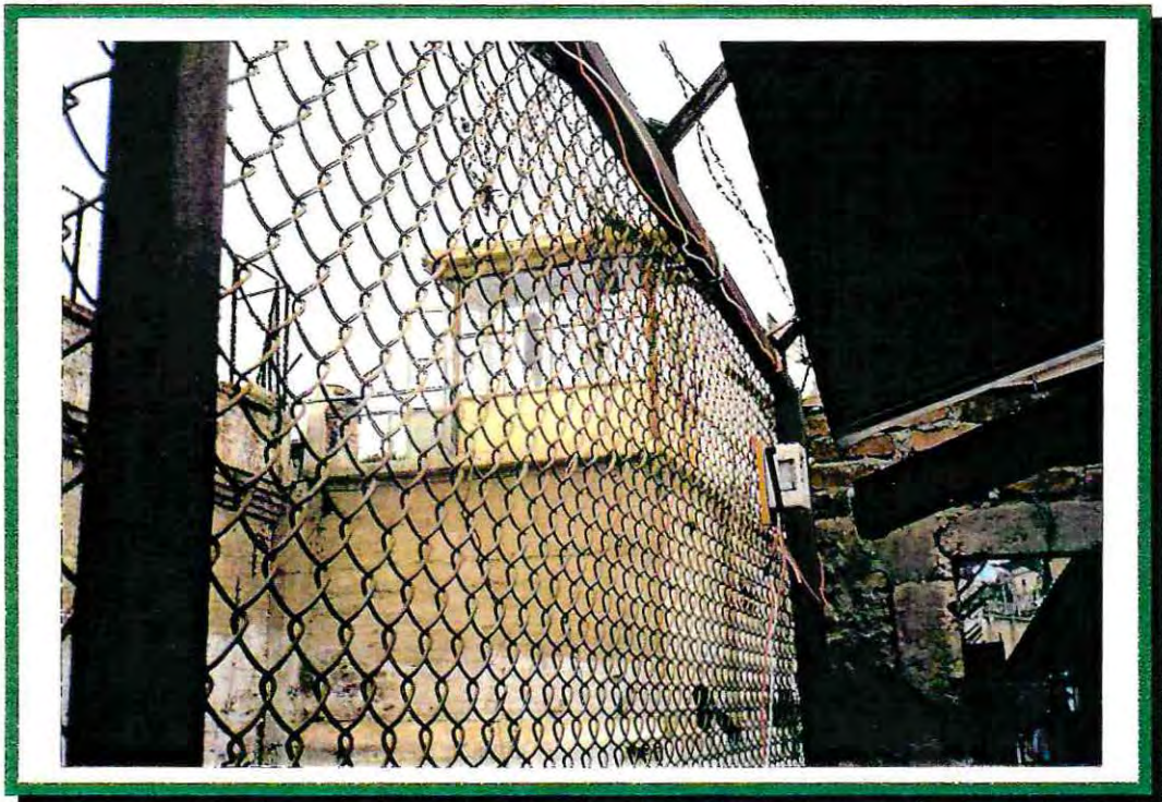
Instalación Eléctrica, realizada por los jóvenes, bajo supervisión del instructor de los Talleres de Electricidad y Soldadura al arco, Sr. Ubaldo Bravo Bórquez.
