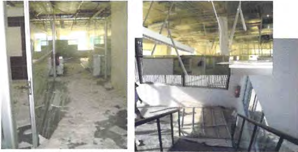
Figura 2 - Colapso en elementos no estructurales durante el terremoto 27F [3].
