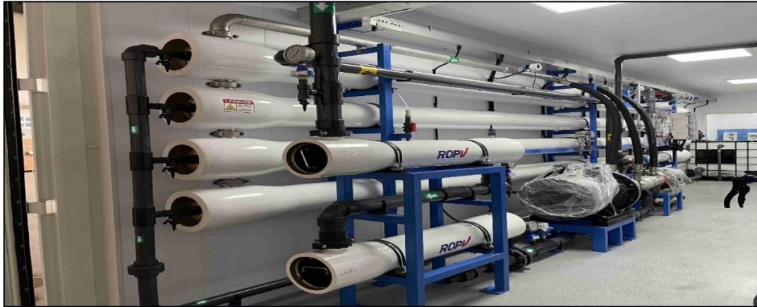
Figura 17: Interior de planta de Osmosis Inversa en contenedor de 40pies. 19
