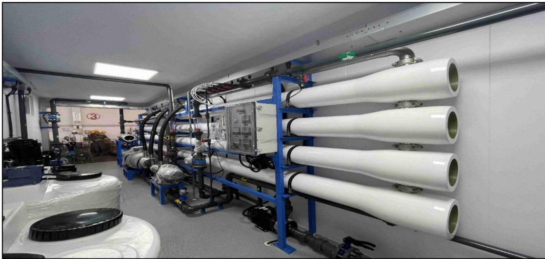
Figura 16: Rack de filtros de Osmosis Inversa en contenedor de 40pies. 18
