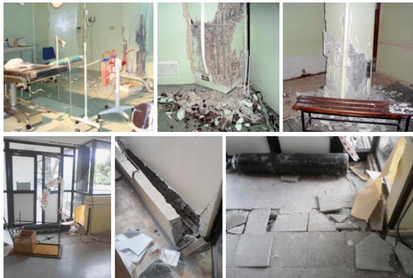
Figura 1.1. Ejemplo de daños estructurales en columnas de hormigón armado y en los contenidos después del terremoto del 27 de febrero de 2010, del Hospital Hernán Henríquez Aravena, Temuco. Fuente: Ministerio de Salud
