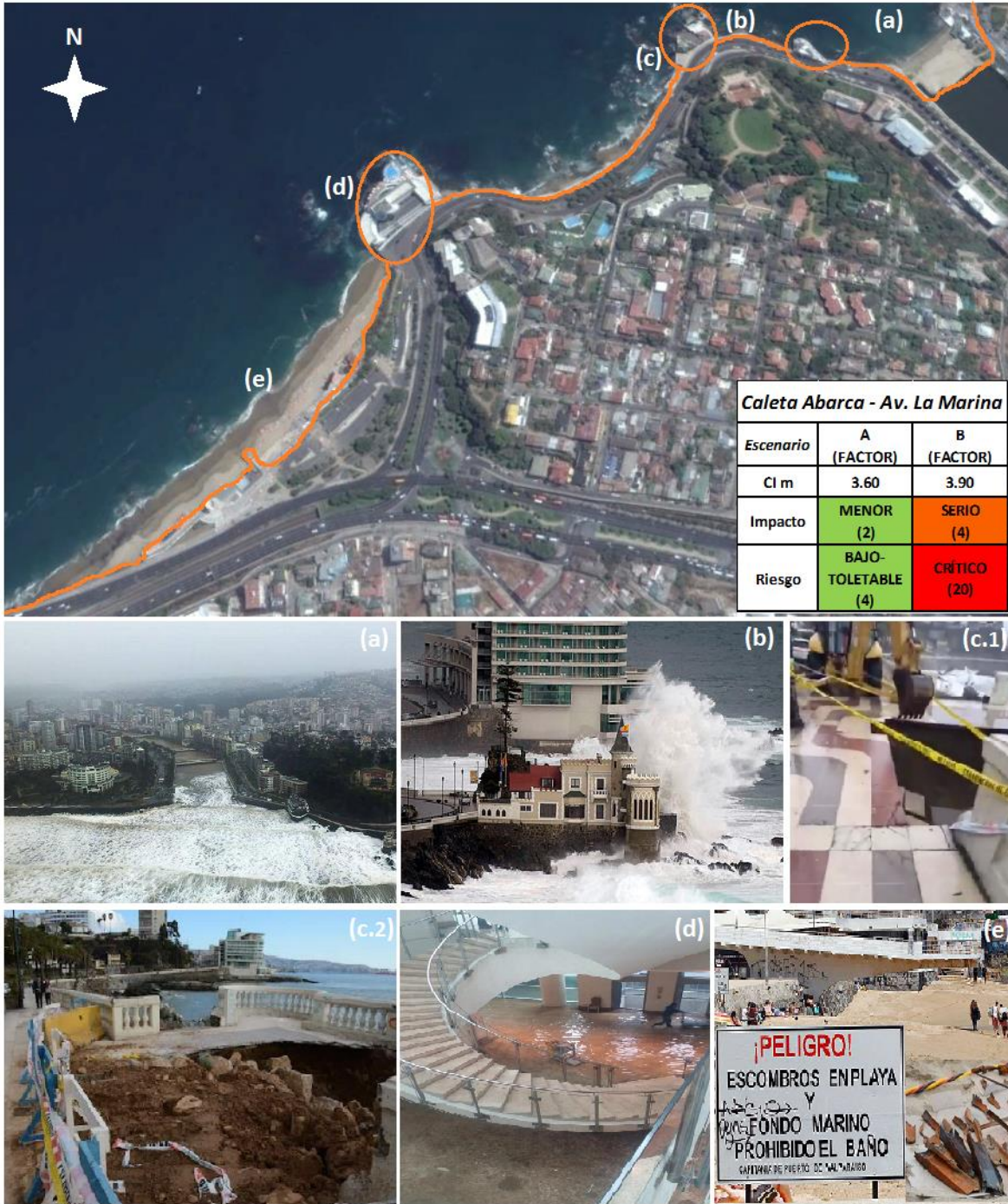
Figura 5-19: Daños en sitio 1 Caleta Abarca - Av. La Marina. (a) Desaparición barrera estero Margarita, (b) Castillo Wulff, (c.1) y (c.2) Socavación paseo costero Av. La Marina Castillo Wolff, (d) Inundación Sheraton, (e) playa Abarca. Elaboración propia, Google Earth
