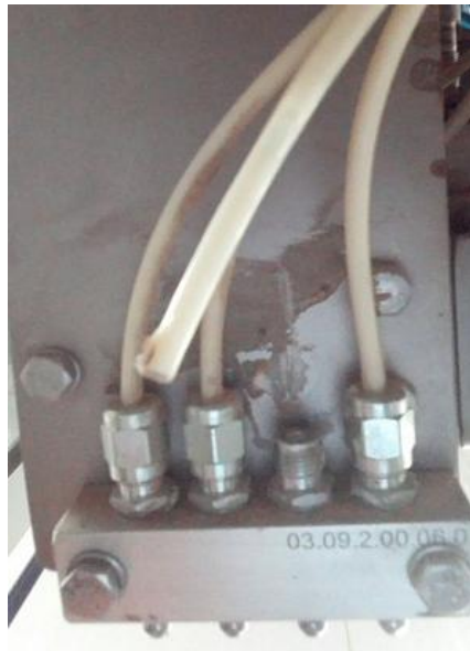
Figura 7.10 - Conexión de mangueras en punto de lubricación.
