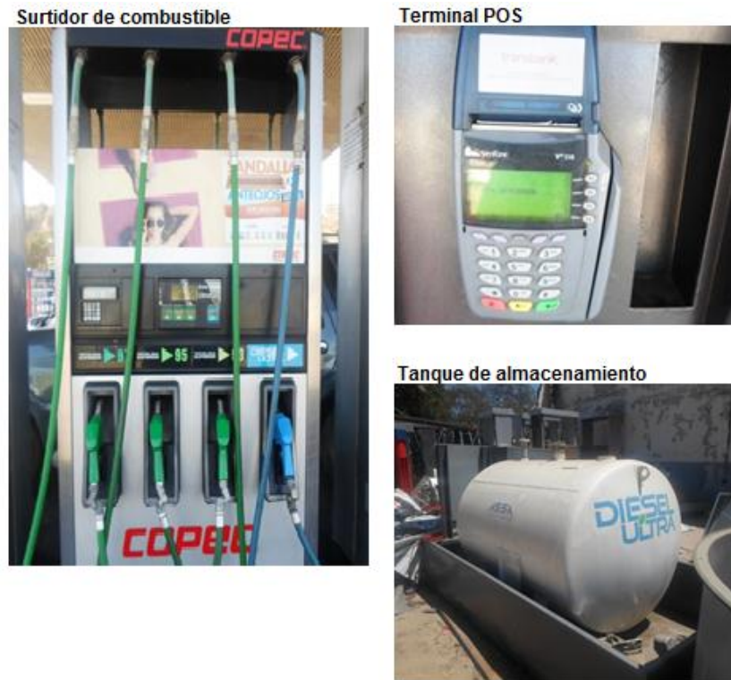
Figura 1.9 - Equipos sujetos a mantención mecánica. Fuente: Elaboración propia.
