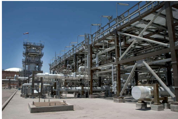
Figura 1.1.- Galería de Imágenes Terminal GNL Quintero. Fuente: http://gnlquintero.cl
