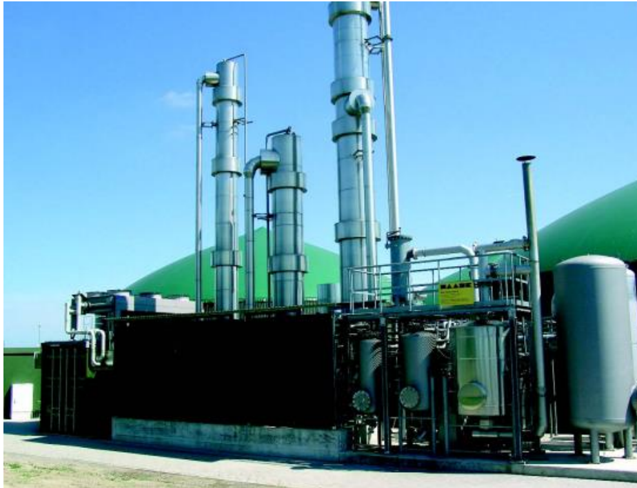
Figura 4.31 Planta de tratamiento de biogás
