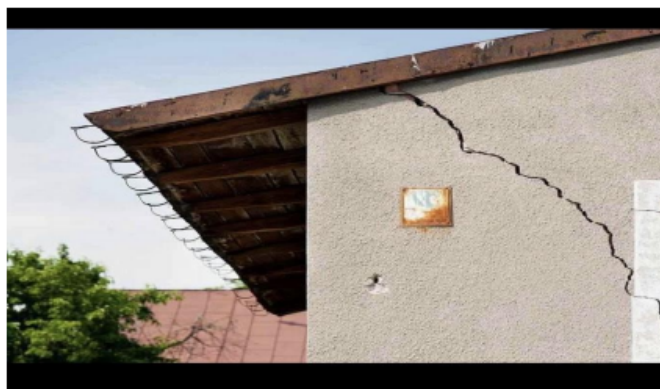
Con una grieta de 1,67M. (Fachada). Muro de hormigón.
