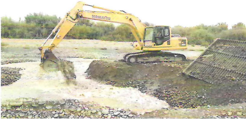
Detección de faenas de extracción de áridos sin autorización municipal en Río Claro, sector Tilcoco – Marzo 23 del 2009.
