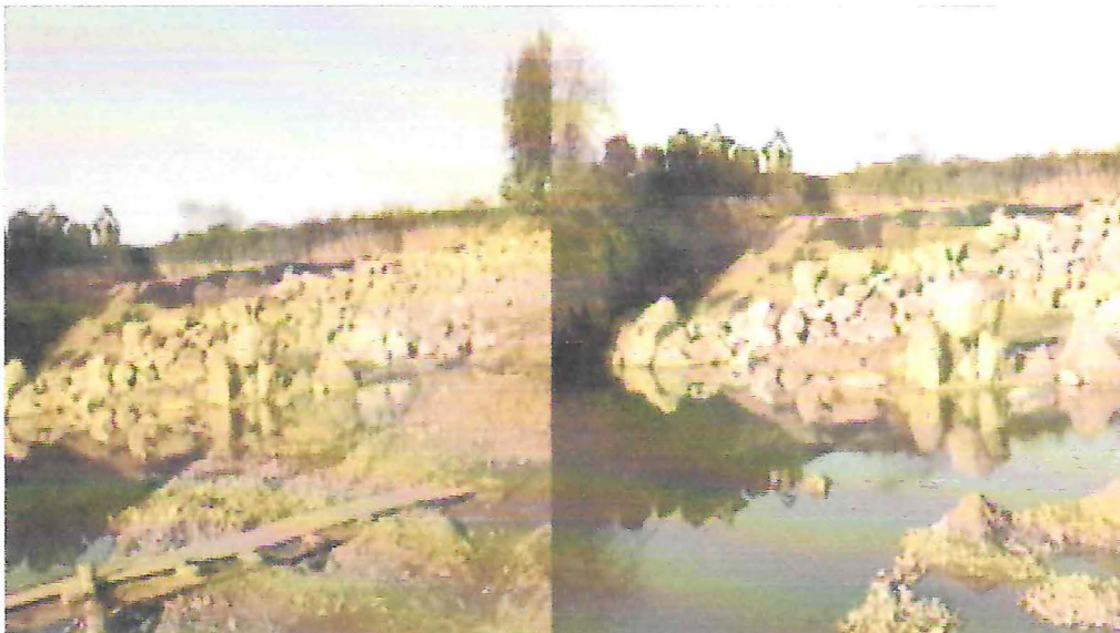
Fotos de trabajos de fortalecimiento con gaviones en la ribera del Río Claro, dañado por erosión del agua, socavando predios agrícolas del sector Uva Blanca. y en sector Alto del Río (abajo).
