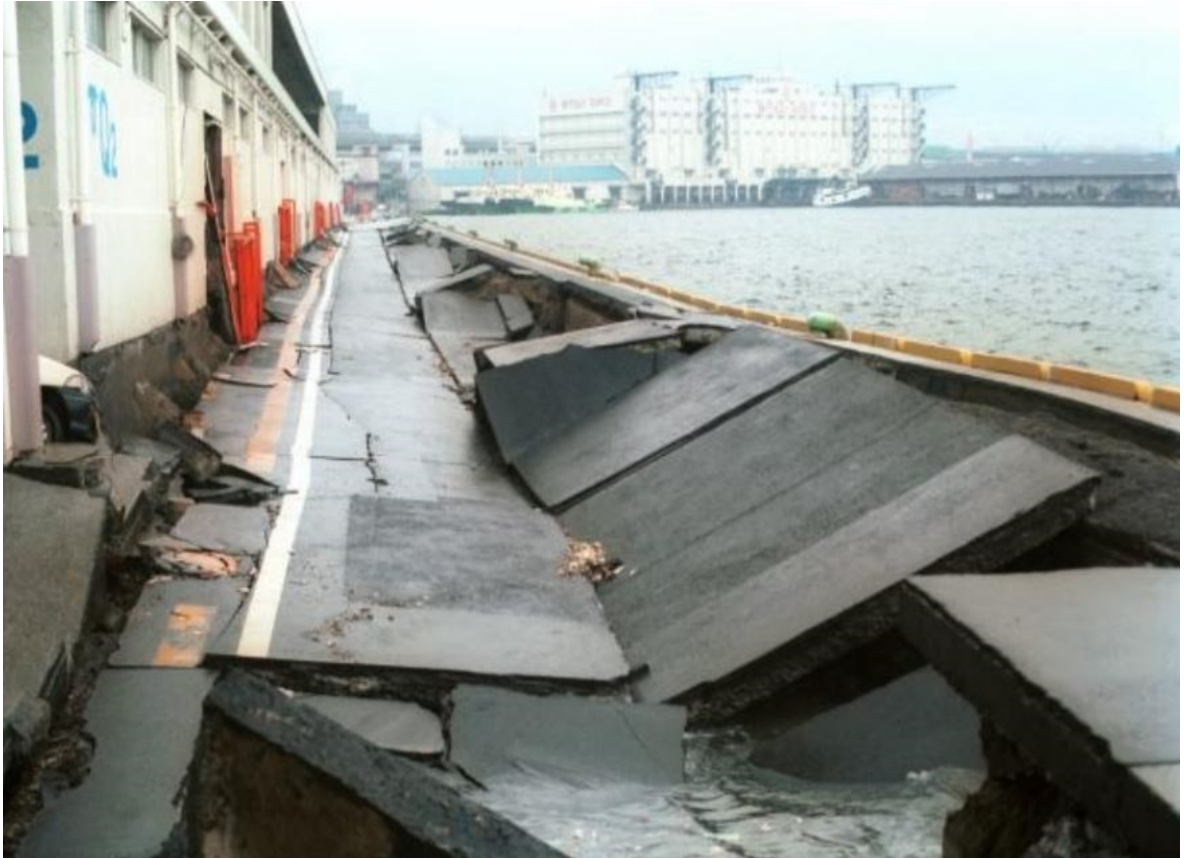
Figura 3-15, Daños en el puerto de Kobe 1995 Fuente: (KUMAGAI, 2011)
