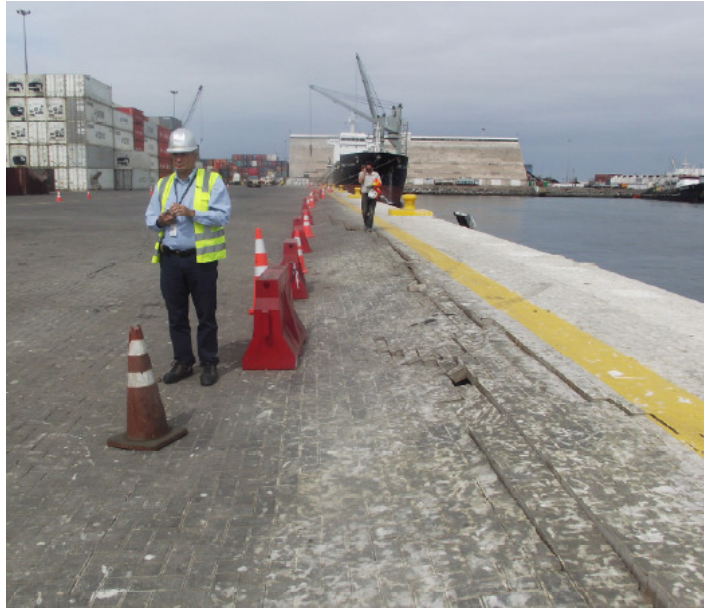
Figura 4-13, daño por socavación de la explanada a lo largo del frente de atraque del sitio 3. Fuente: (EPI, 2014)
