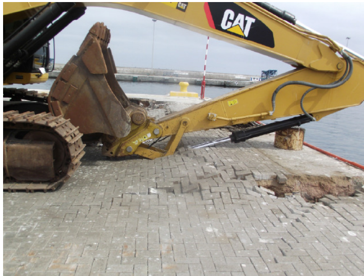
Figura 4-14, daño en el cabezo del espigón por socavación. Fuente: (EPI, 2014)
