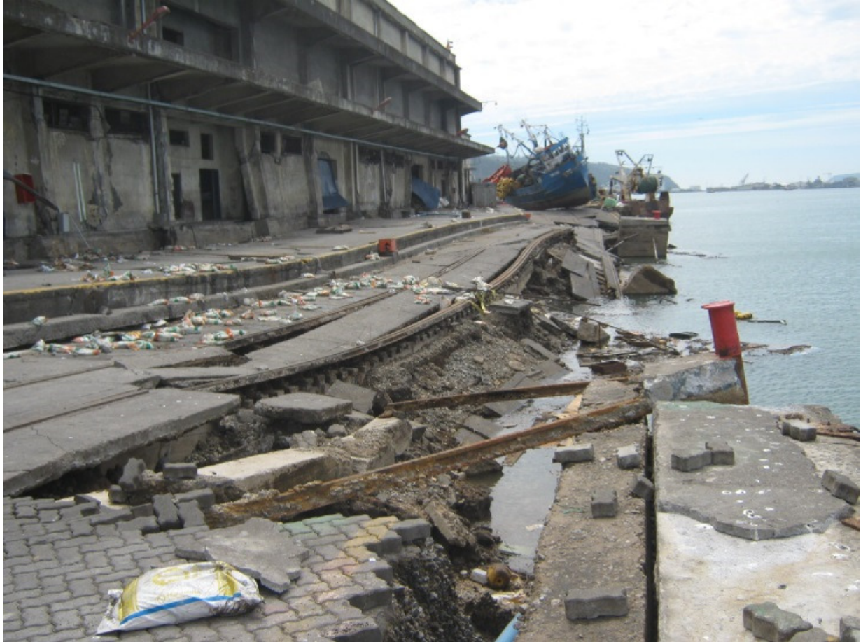
Figura 6-2, daños en el puerto de Talcahuano Fuente: (Saravia, 2017)
