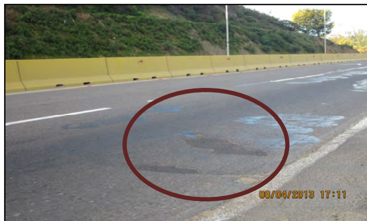
Figura 3.2 - Fotografía de la Fatiga del Material: Baches en el Pavimento. Km 8.1. (elaboración propia)
