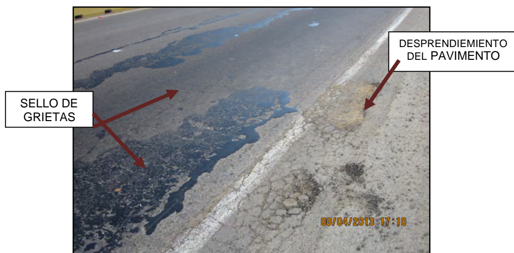
Figura 3.3 - Fotografía de Lechada asfáltica para sello de grietas. Desprendimiento del Pavimento. Km. 8.1. (elaboración propia)
