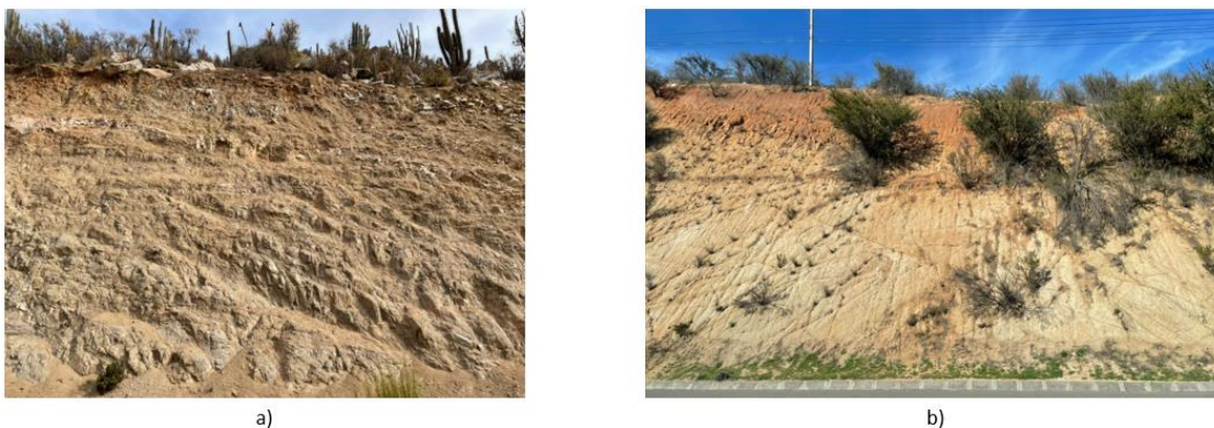
Figura 1.1 - Talud de suelo residual ubicado en a) Canela baja, IV Región y b) Villa Alemana, V Región. Fuente: Elaboración propia.
