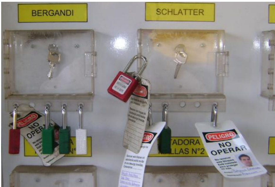
Figura 31 Implementación de candados de seguridad para el proceso de limpieza.(Armacero Matco S.A, 2017)
