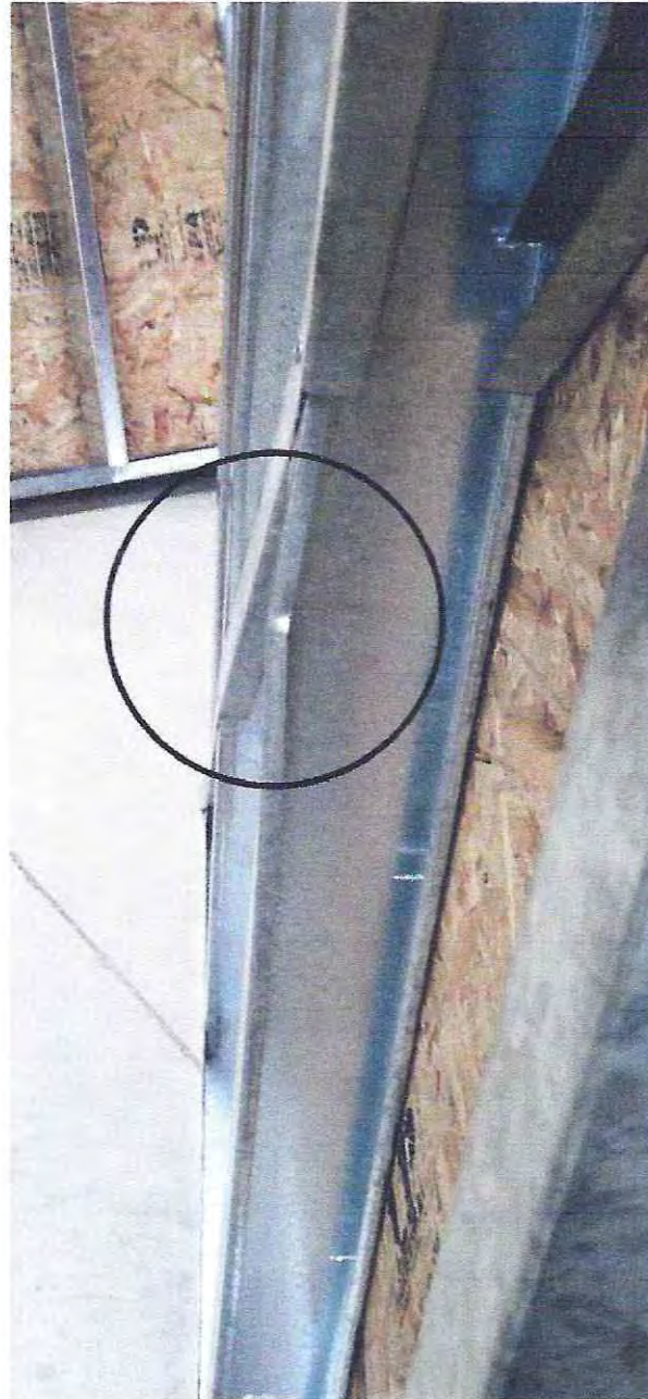
Figura 4.24- Pandeo local montante CA
