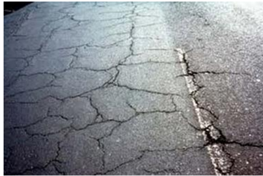
Figura 2.17 – Fisuramiento (por fatiga) tipo piel de cocodrilo. (Fuente: “Google Images”).
