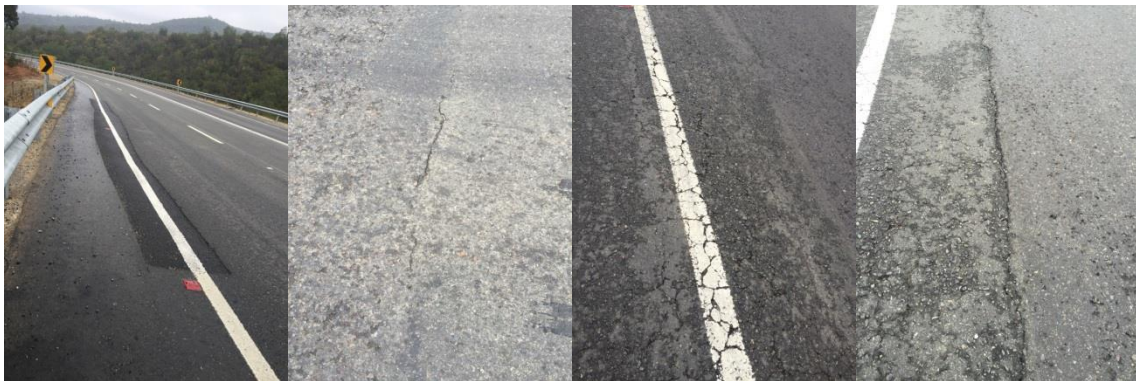
Figura 6.1 – Imágenes de deterioros prematuros presentes en la segunda entrega del mejoramiento de pavimentación en la ruta F-50.
