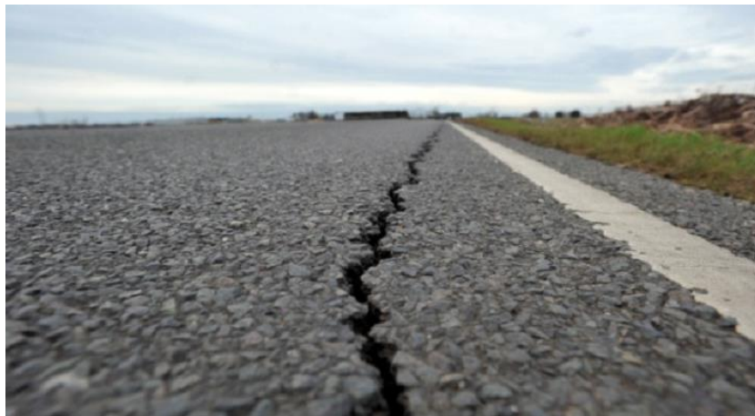
Figura 2.19 – Fisuramiento por baja temperatura. (Fuente: “Google Images”).
