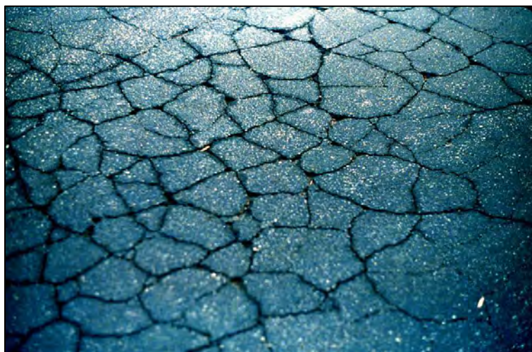
Figura 2.3- Falla de agrietamiento por fatiga del asfalto.
