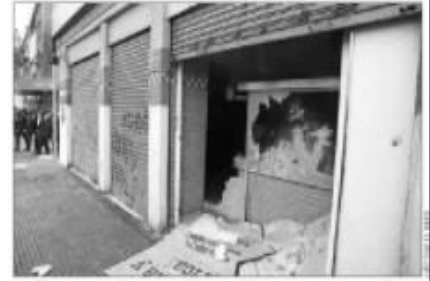
Las llamas, que alcanzaron el interior del local, arrasaron con múltiples artefactos electrónicos y con algunos de los computadores que había en el lugar.
