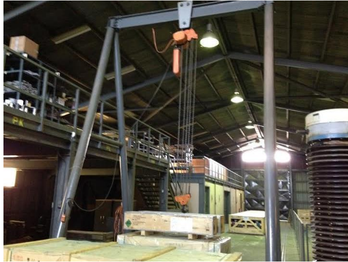
Figura 6.8: Bodega Ubicada en Cerro Navia, Empresa Transelec Fuente: Fotografía obtenida desde la empresa
