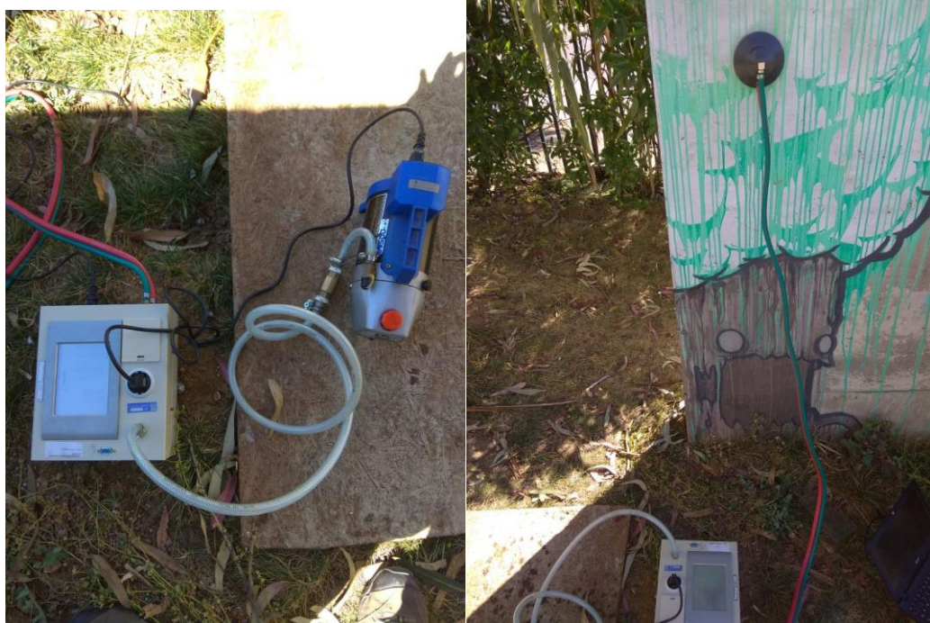
Figura 4.9 Instalación equipo Torrent Fuente: Elaboración propia
