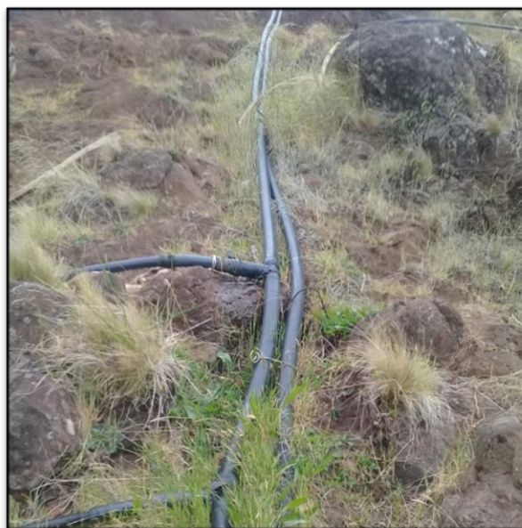
Figura N° 14: Planzas negras pertenecientes a la red de distribución del sistema.
