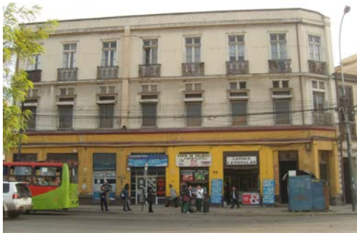
Inmueble pintado parcial, es una obra alterada.
