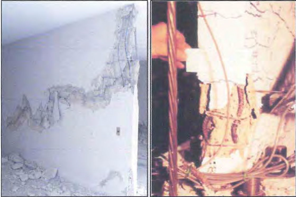
Figura 1.19 y Figura 1.20 Muro eje 5 (derecha) muro T2 [17].
