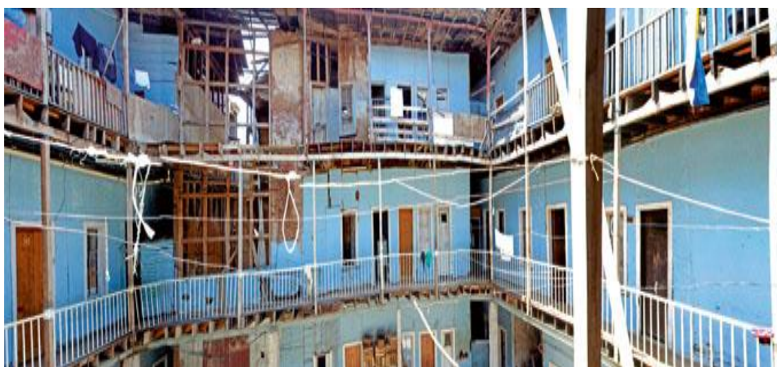
IMAGEN 3: Deterioro de la infraestructura del Inmueble
