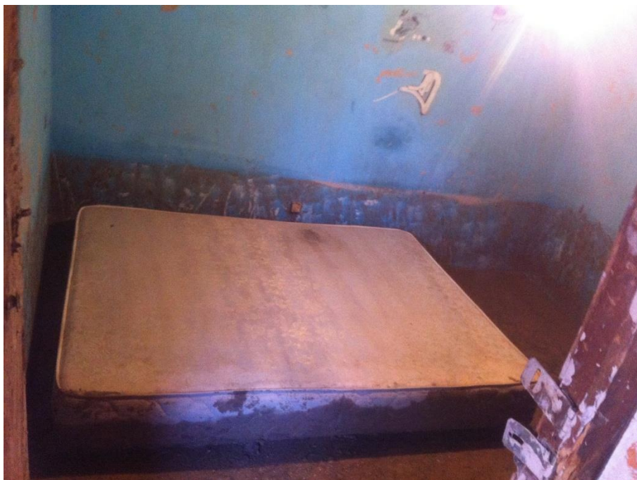
Interior de la habitación inundada por el barro
