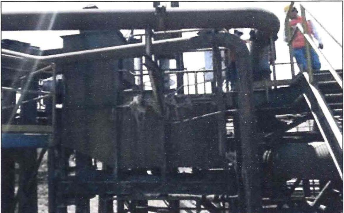
Figura 21: Personal de P&A constatando las fallas del alimentador del espesador de AA.
