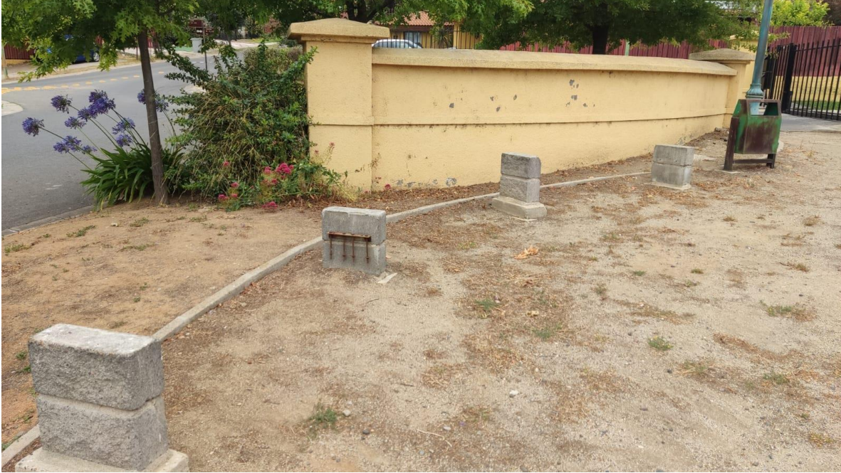
Foto N° 5: Plaza Laguna La Luz #2; zona de bancas faltantes.
