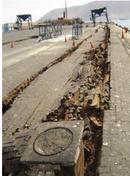
Figura 68: Puerto de Iquique- Terremoto 2014
