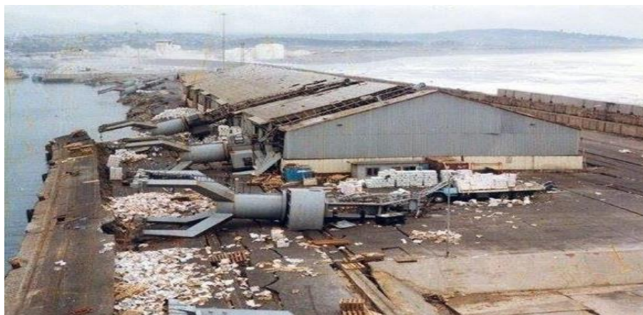
Figura 72: Grúas en el suelo Puerto de San Antonio- Terremoto 1985
