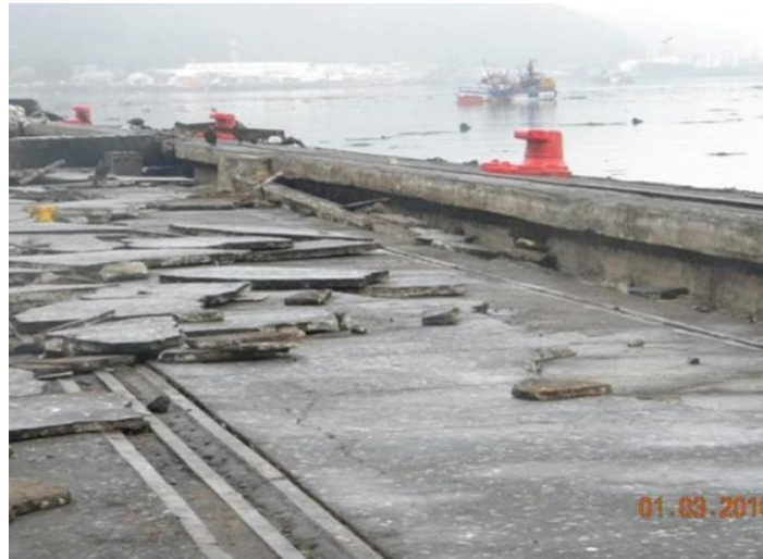
Figura 76: Pavimento del Puerto de Talcahuano- Terremoto 2010
