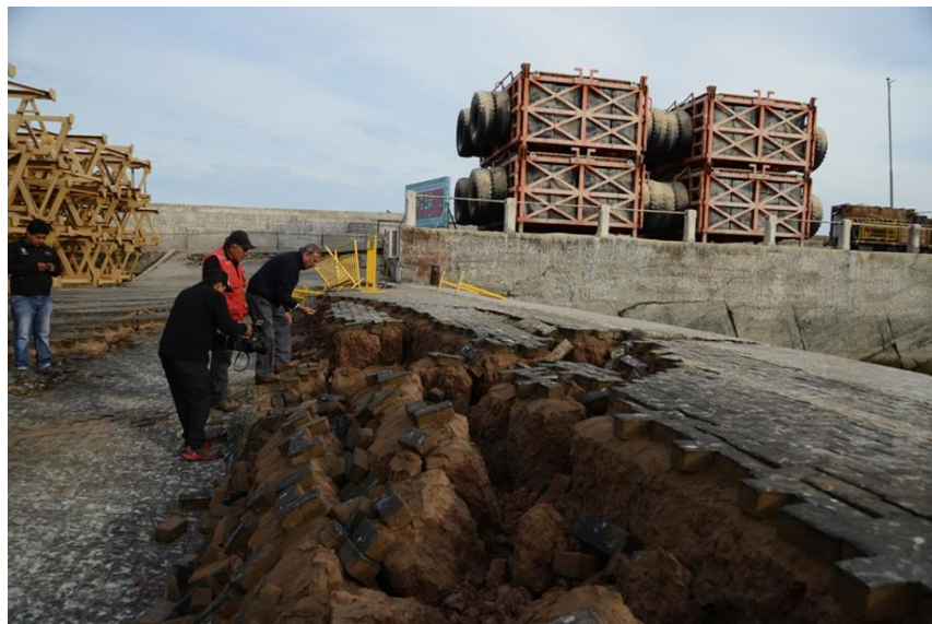
Figura 69: Daños en los sitios 1 y 2 del Molo, tras el terremoto 2014 y sus réplicas, Puerto de Iquique
