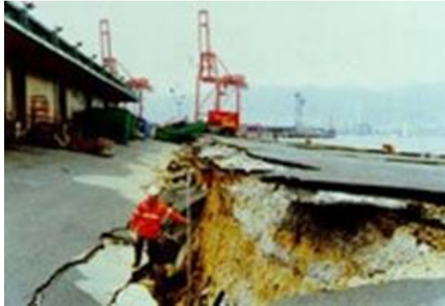
Figura 73: Instalaciones Puerto San Antonio- Terremoto 1985
