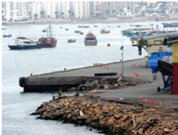
Figura 79: Puerto De Coquimbo- Terremoto 2015
