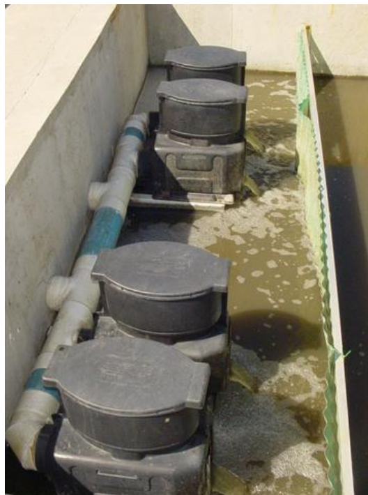
Figura 12. Fotografía de los Cloradores de la cámara de cloración.
