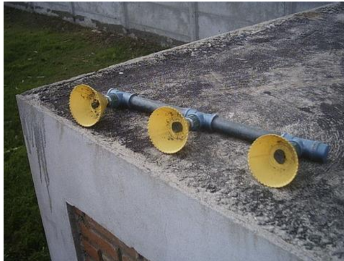
Figura 10. Fotografía de los Difusores utilizados en la PTAS.
