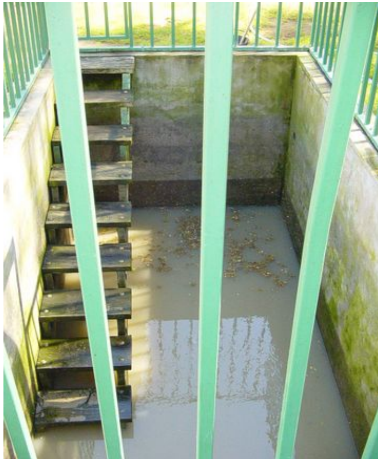
Figura 25. Fotografía de Cámara de rejas parcialmente inundada.
