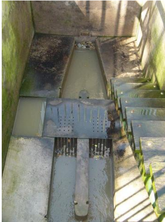
Figura 6. Fotografía en vista superior del sistema de Desbaste.
