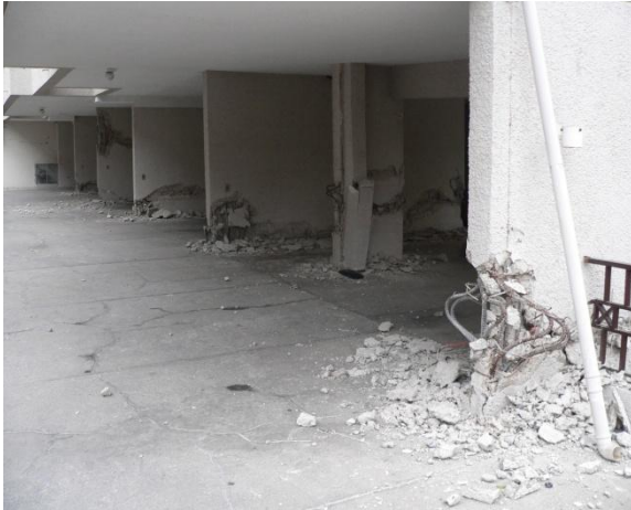
Figura 2.4 - Daños estructurales en Edificio "Toledo" (demolido).
