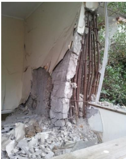
Figura 2.6 - Daños estructurales en Edificio "Festival" (por demoler).
