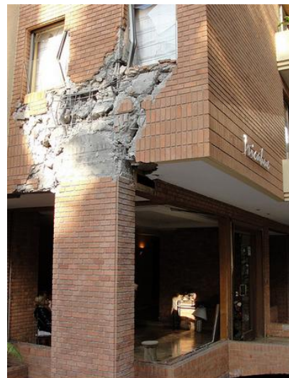
Figura 2.7 - Daños estructurales en Edificio "Tricahue" (reparado).
